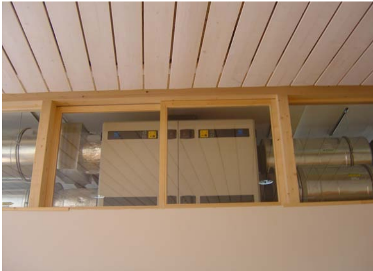
Lüftungszentrale als zielgerichtete Sichtkomponente
